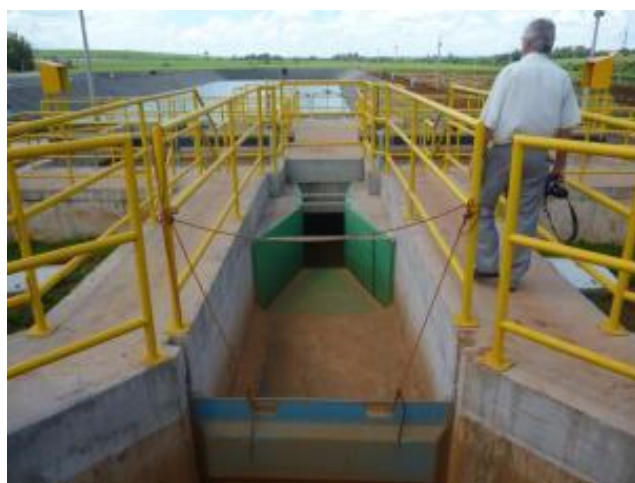
Foto 4.30 – Calha Parshall de Entrada
