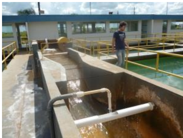
Foto 4.8 – ETA – Calha Parshall
