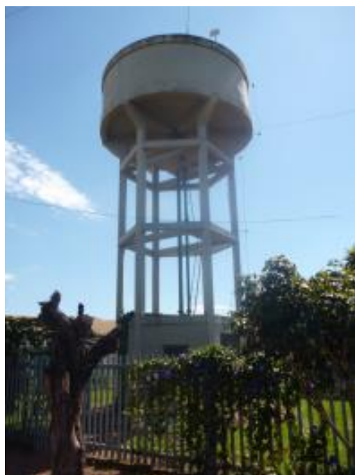
Foto 4.23 – Reservatório R-15 (Taquari Bairro)
