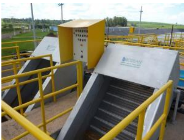
Foto 4.29 – Sistema de Gradeamento
