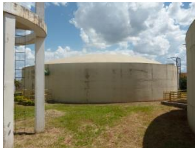
Foto 4.14 – Centro de Reservação Santana
