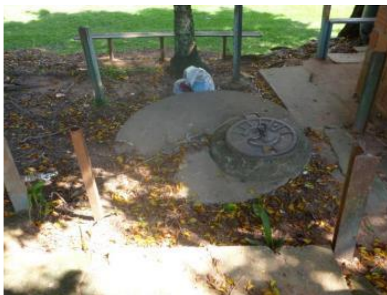
Foto 4.33 – EEE Taquari Bairro – Bomba Inserida no Poço de Visita
