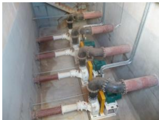
Foto 4.26 – Estação Elevatória de Esgotos Final – Conjuntos Motobomba
