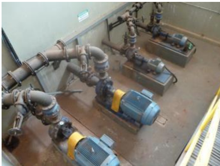
Foto 4.19 – Casa de Bombas do C.R. Santana – Conjuntos Motobomba da EEAT1 e EEAT2
