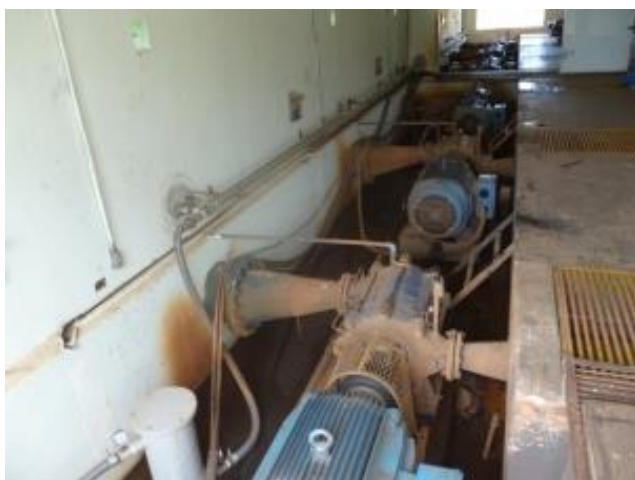
Foto 4.3 – Os Seis Conjuntos-Motobombas Instalados na EEAB1
