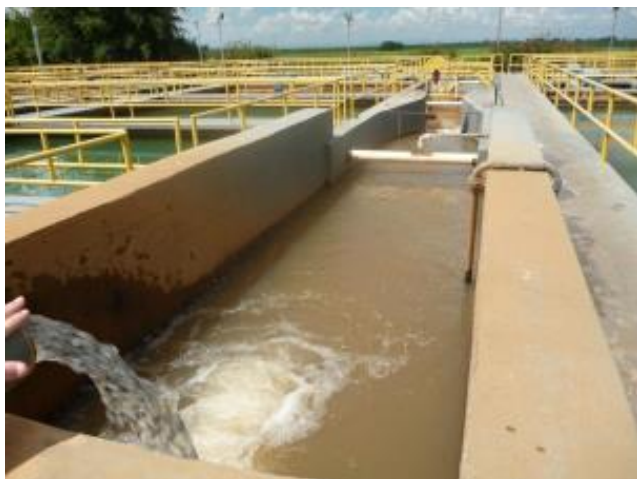
Foto 4.7 – ETA – Chegada da Água Bruta
