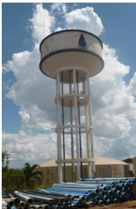
Foto 4.15 – Centro de Reservação Santana
