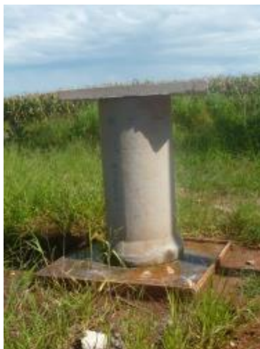
Foto 4.20 – Poço Profundo P-02 (Bairro Taquari Ponte)
