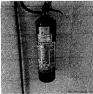
Foto 1 - Extintor de incêndio da ETA em Leme
