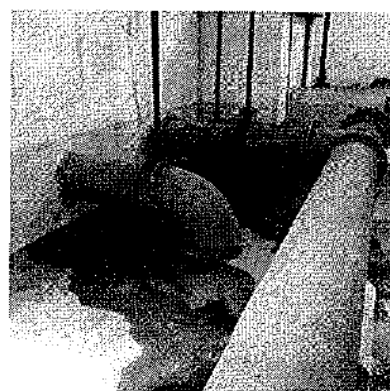
Foto 8 - Vazamento na Sala de bombas da ETA em Leme
